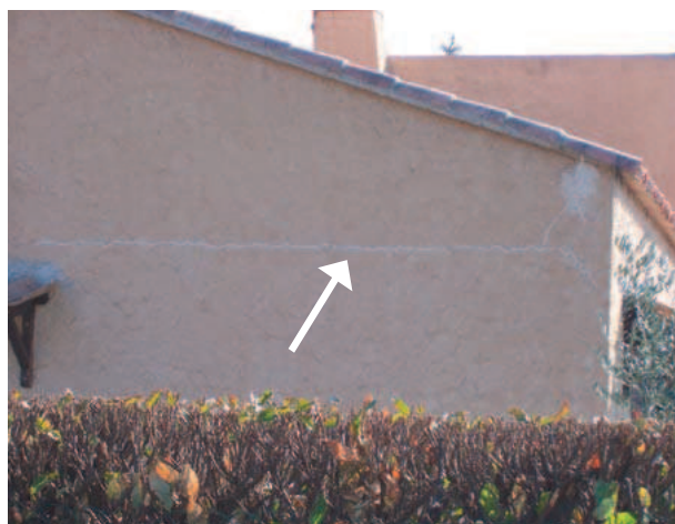
Fissuration traduisant un décollement de la structure par absence de liaisonnement entre niveau bas et combles.
